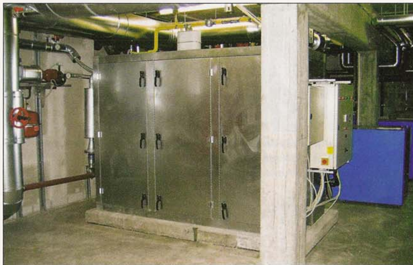
Bild 1: Gasbetriebenes BHKW für die Strom- und Wärmeerzeugung
